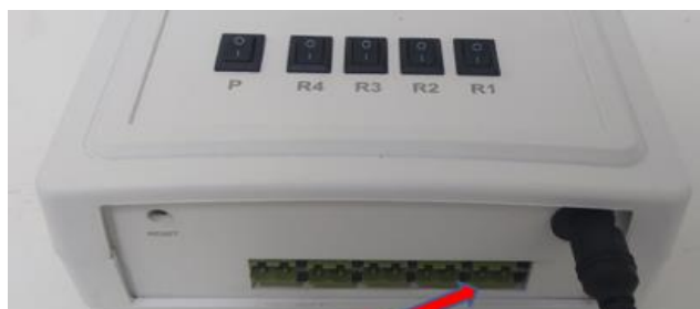
نصب ترمینال های شیر برقی
